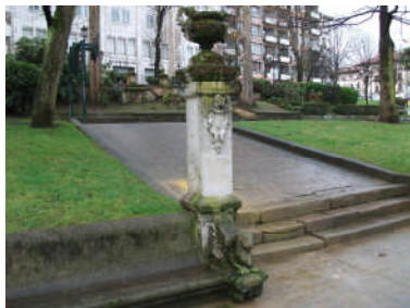
Estado previo a la reparación
